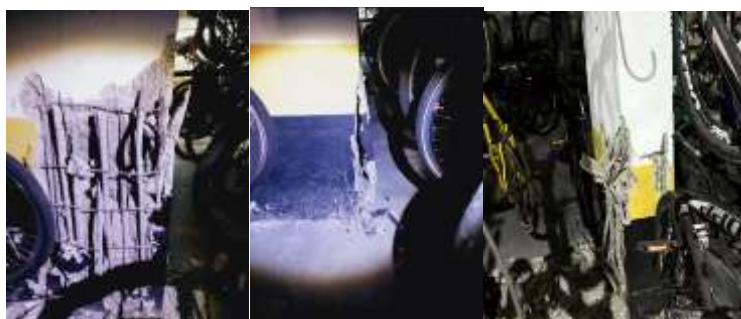
Figura 02 - Demonstração do colapso na estrutura
